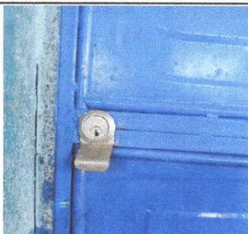
Foto 3: Sustrucción de chapa
